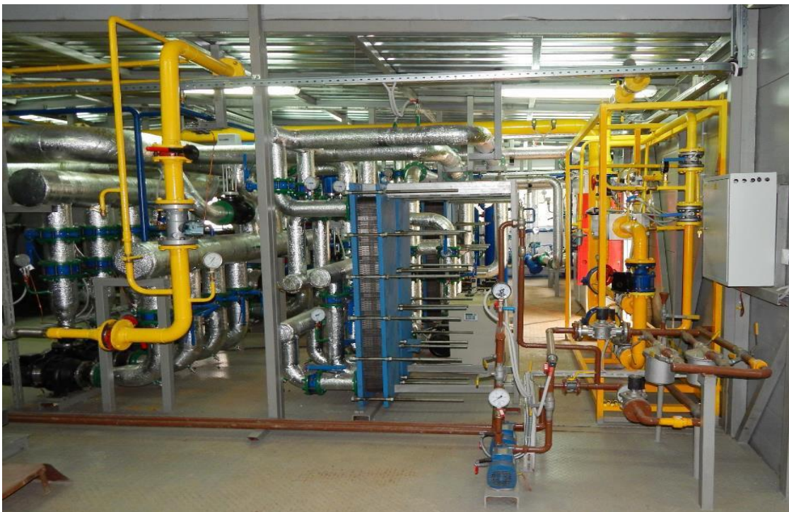
Фото 2. Центральный тепловой пункт для концентрации тепла и его распределения от КГУ и пикового котла: в летний период на АБХМ, в зимний – на теплоснабжение.
