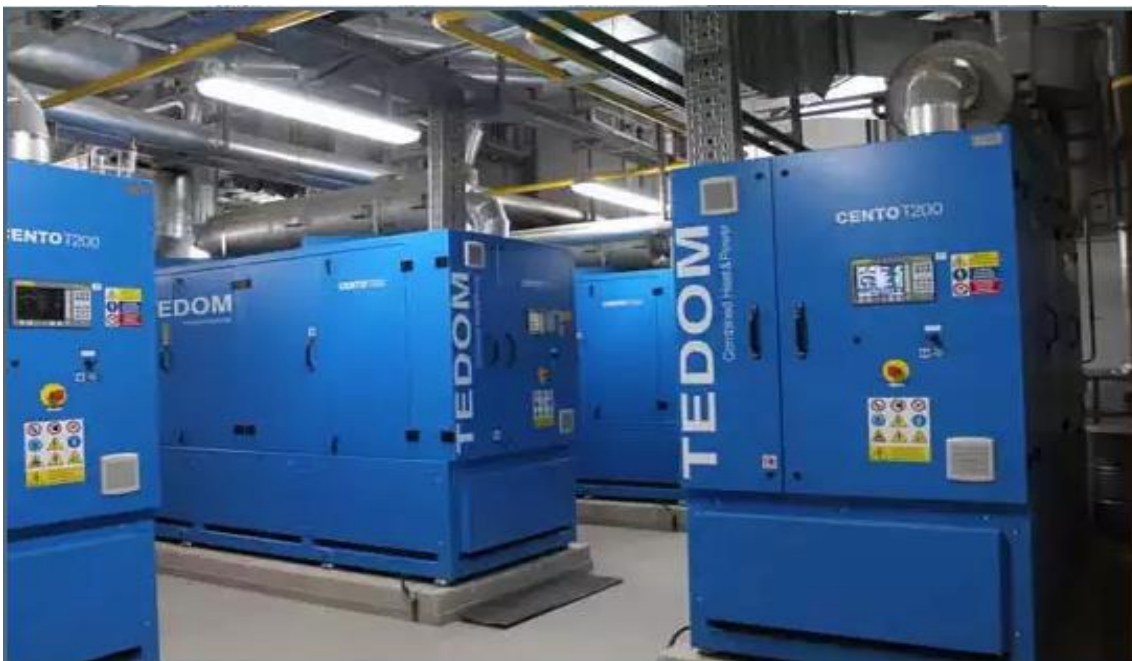
Рис. 3 Модульные когенерационные установки
