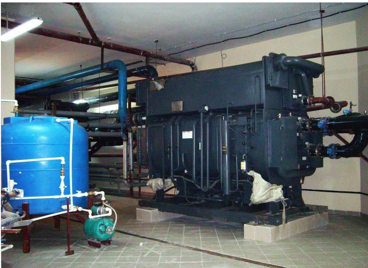
Фото 4. Двухступенчатая АБХМ с системой водоподготовки в стационарной котельной.
